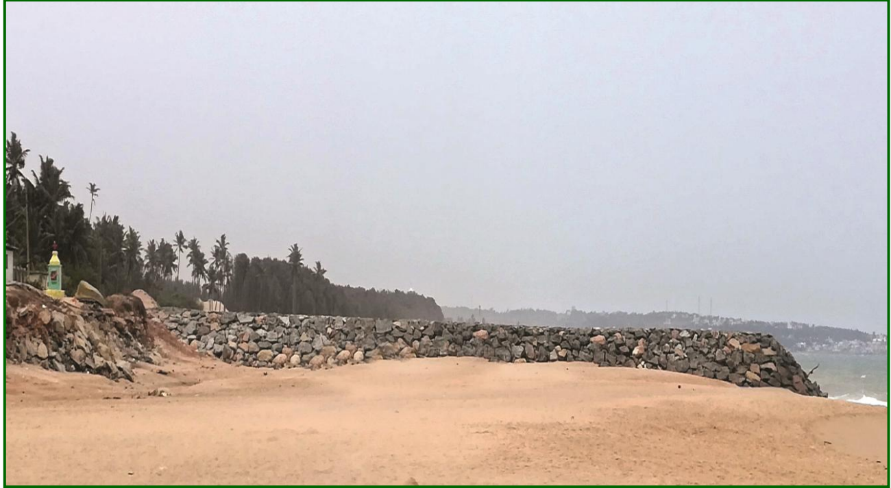
கன்னியாகுமரி மாவட்டம் - மண்டைக்காடு புதூரில் அமைக்கப்பட்டுள்ள தூண்டில் வளைவு (மதிப்பீட்டுத் தொகை ரூ.7.82 கோடி)
