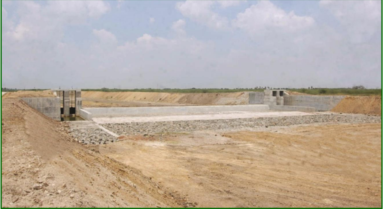
விருதுநகர் மாவட்டம் - ஆவுடையாபுரம் கிராமத்தில் காளப்பெருமாள்பட்டி கண்மாபுக்கு நீர்வழங்கும் பொருட்டு கௌசிகா நதியின் குறுக்கே கட்டப்பட்டுள்ள அணைக்கட்டு (முதிப்பீட்டுத் தொகை ரூ.3.50 கோடி)
