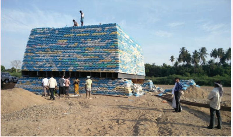
கரூர் மாவட்டம், அமராவதி நதியின் குறுக்கே மேல்பாளையம் – கோயம்பள்ளியை இணைக்கும் பாலப் பணிக்கு ஆழ்துளைத் தாங்குதூண் சுமை சோதனை
