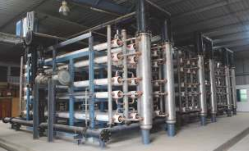
வீரபாண்டி பொது கழிவுநீர் சுத்திகரிப்பு நிலையத்தின் நுண் வடிகட்டுதல் – எதிர்மறை சவ்வூடு பரவல்
